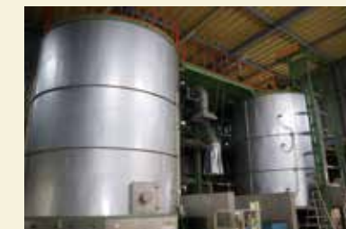
C 堆肥化発酵槽（P.9）
