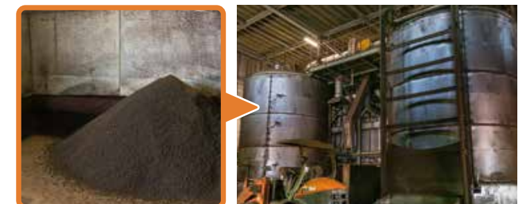
堆肥化発酵槽
