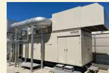
E 発電設備
