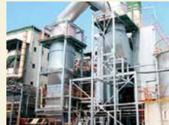
D ガス冷却塔
