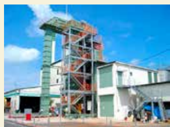
A ドラム缶破砕設備
